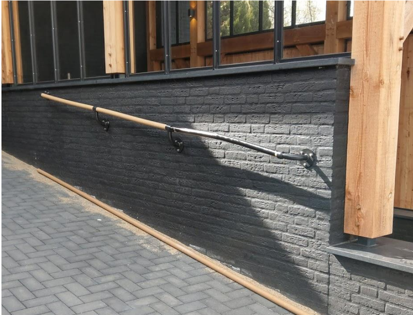
Figuur 9: Defecte trapleuning door wateropname
